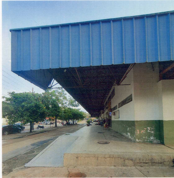
Figura 08: Frente do Terminal Rodoviário, onde pode-se observar desgastes de pintura de paredes e da estrutura da cobertura, bem como patologias no piso e elementos de acessibilidade inadequados.
