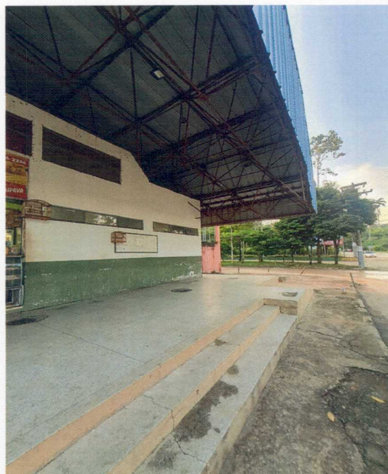
Figura 09: Frente do Terminal Rodoviário, onde pode-se observar desgastes de pintura de paredes e da estrutura da cobertura, bem como patologias no piso e elementos de acessibilidade inadequados.
